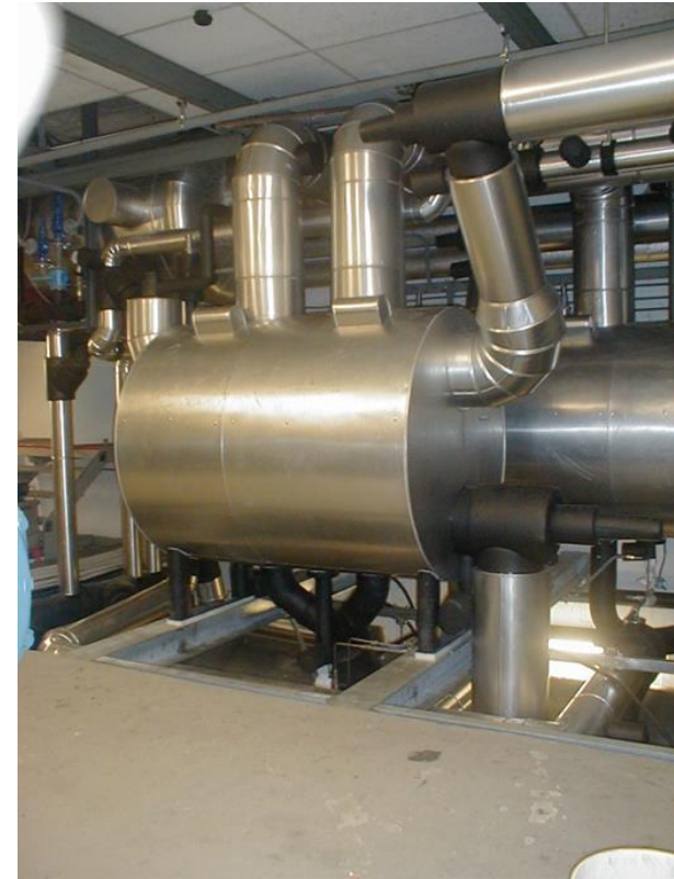
2 NH 3 - / CO 2 Kaskadenwärmeaustauscher
